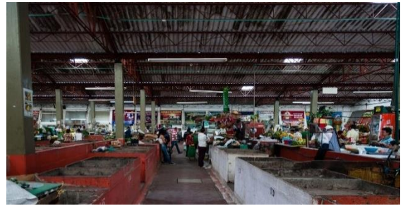
Imagen 4: Deterioro y una imagen desfavorable. Fuente: Sevillano, 2012.
