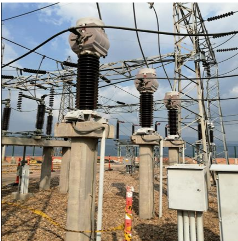
Imagen .7 transformadores de corriente
