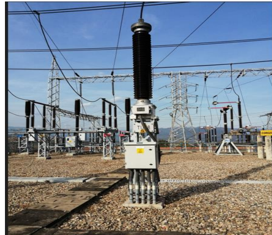
Imagen .8 transformadores de tensión
