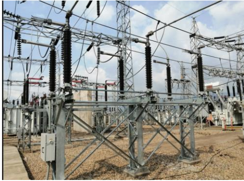
Imagen .5 Seccionador de potencia
