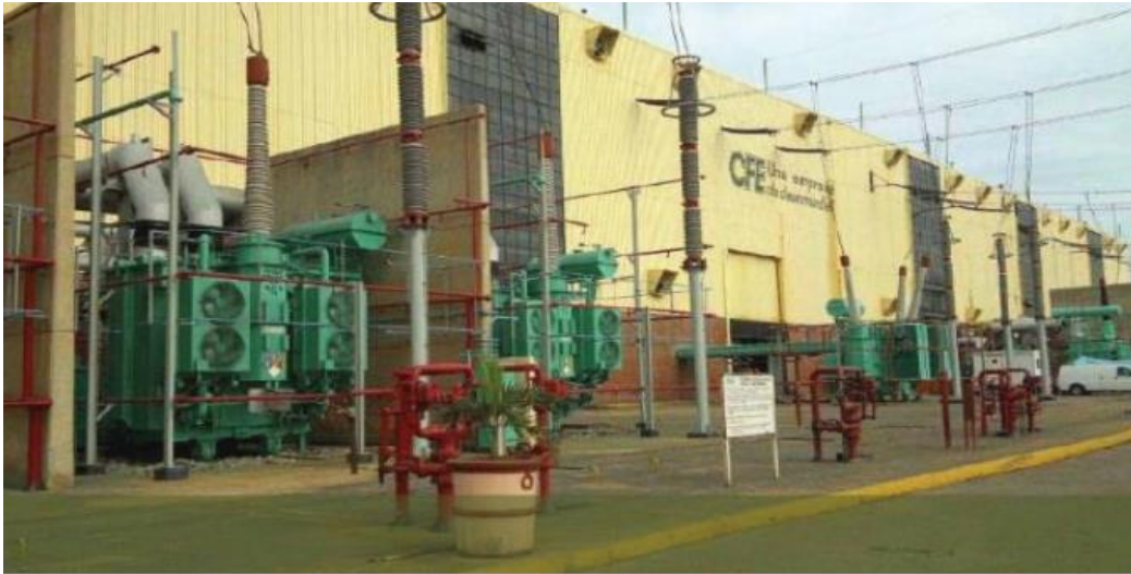
Figura 8 Subestación Eléctrica elevadora
