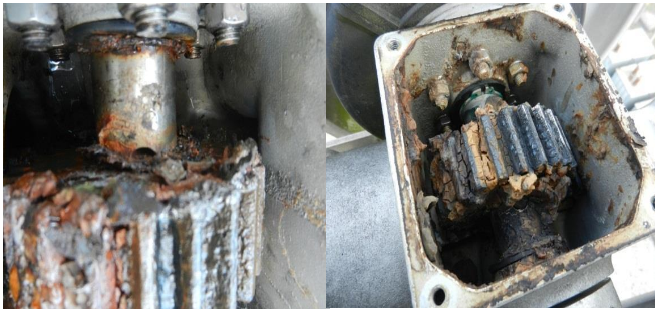
Figura 33 Falta de mantenimiento o mantenimiento inadecuado
