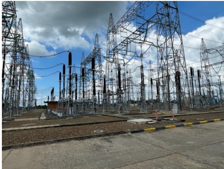
Figura 10 Subestación de Maniobra
