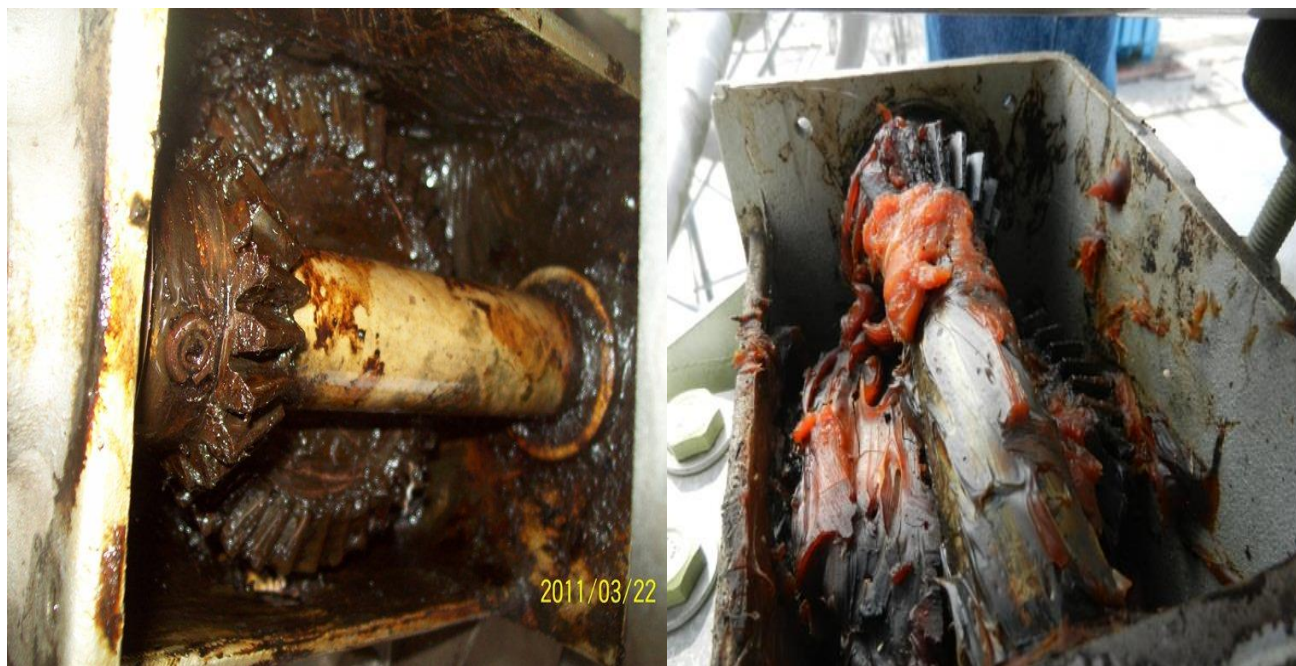
Figura 34 Falta de mantenimiento
