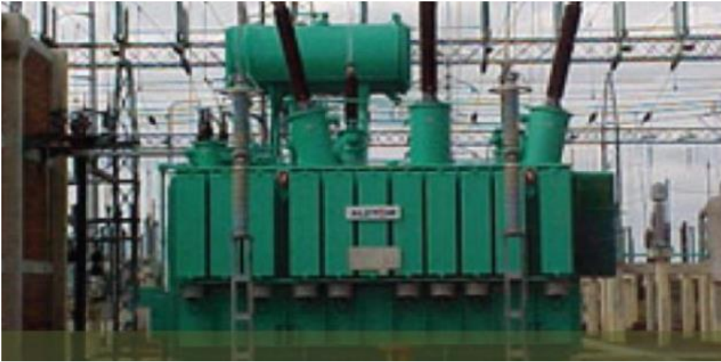
Figura 9 Subestación eléctrica reductora
