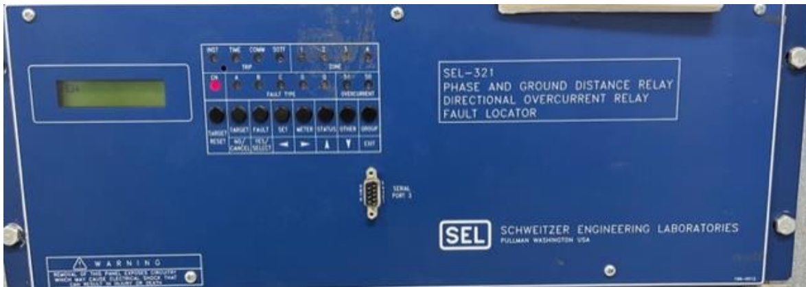
Fuente 29 Elaboración con información suministrada por ISA INTERCOLOMBIA
