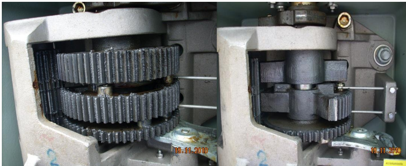
Fuente 34 Elaboración con información suministrada por ISA INTERCOLOMBIA
