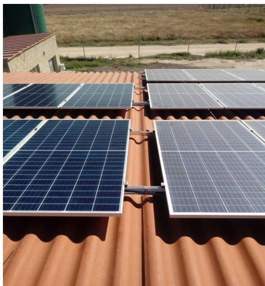
Fig. 8 Panel limpio y panel sucio
