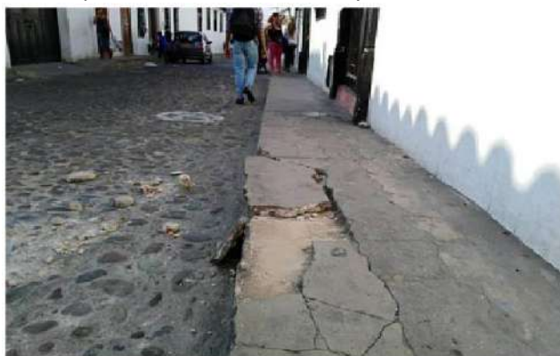
Figura 4. Condición del espacio Público en andenes y calzadas
