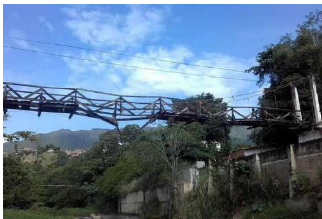
Figura 1. Estado de abandono del puente colgante en el municipio de Girón
