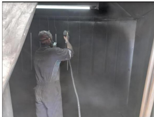
Figura 25. espacios de trabajo para el proceso de la aplicación de pintura electrostática.
