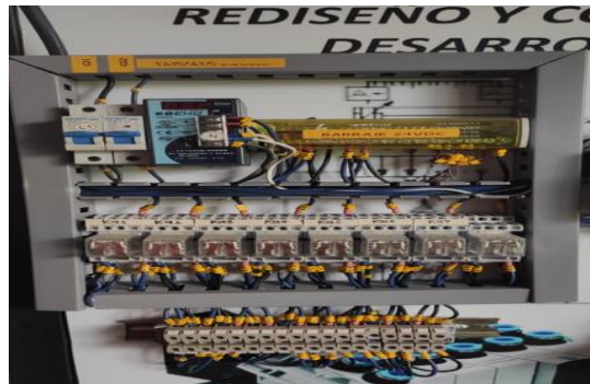
Fig. 8 Tablero neumático del laboratorio de Automatización (foto tomada por el autor)
