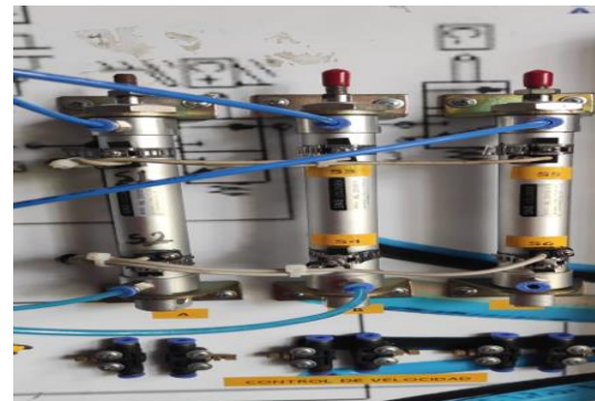
Fig. 9 Tablero neumático del laboratorio de Automatización (foto tomada por el autor)
