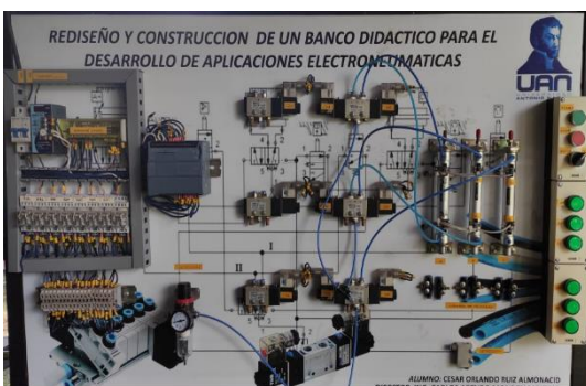
Fig. 6 Tablero electroneumático del laboratorio de Automatización (foto tomada por el autor)
