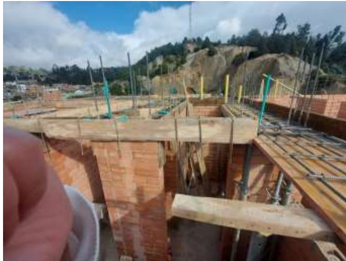
Figura 16. Vista de tubería conduit en vigas dinteles y vigas canales para apartamentos de quinto piso bloque B.
