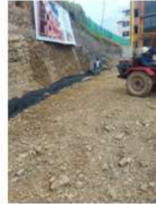
Imagen 5. Elaboración del filtro del bloque C.
