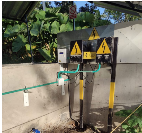
Figura 2-33: Disposición del tablero eléctrico principal de la planta (Fuente: los autores).
