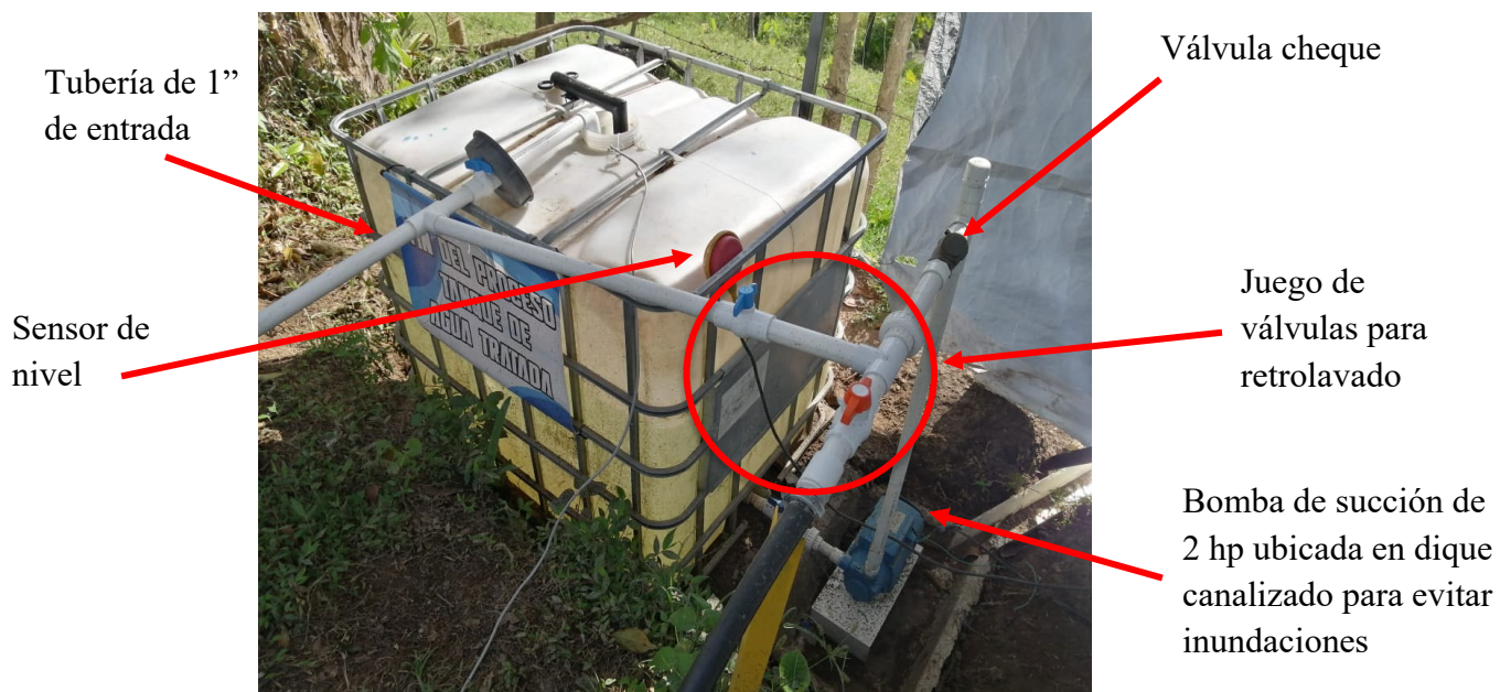
Figura 2-12: Tanque de almacenamiento de agua final (Fuente: los autores).
