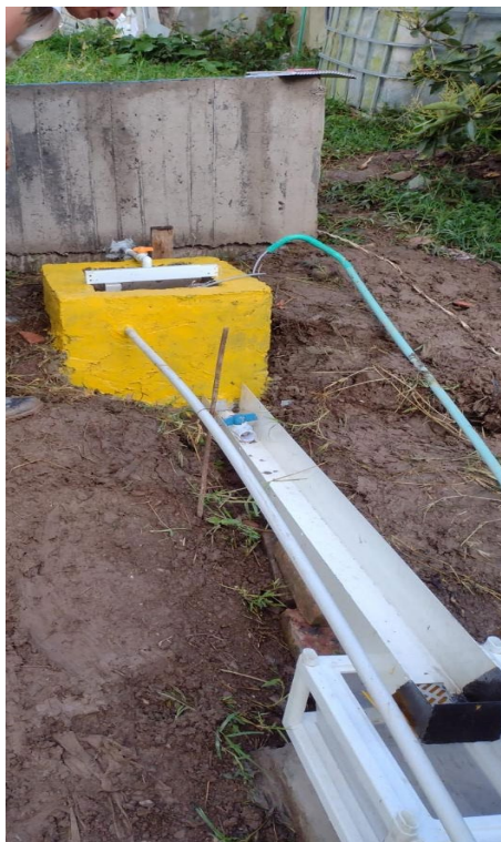
Figura 2-15: Salida trampa de grasas y salida con canal para el mantenimiento (Fuente: los autores).
