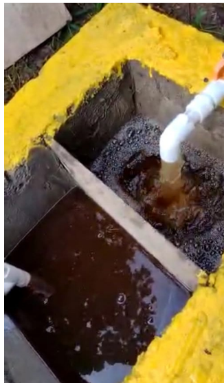
Figura 3-1: Trampa de grasas (Fuente: Los autores).
