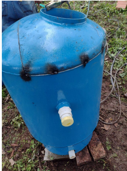
Figura 2-18: Soldadura de electrodo manual revestido en la tapa del tanque de filtración. (Fuente: los autores).
