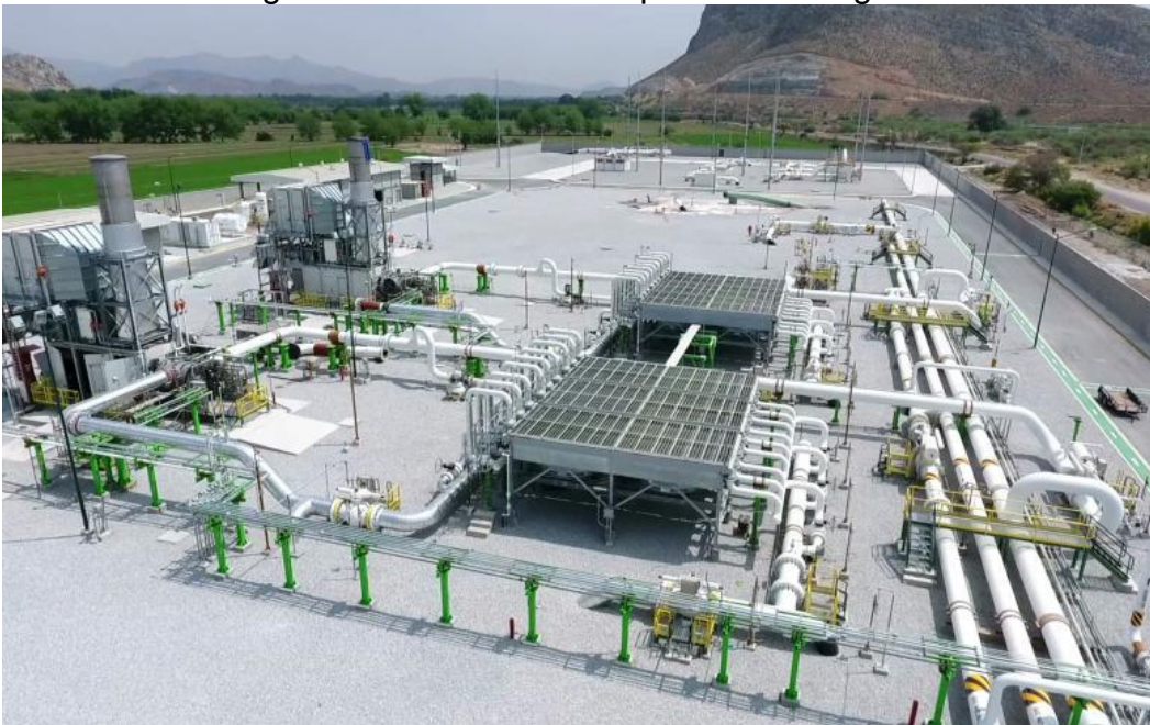
Figura 6. Estación de compresión La Laguna
