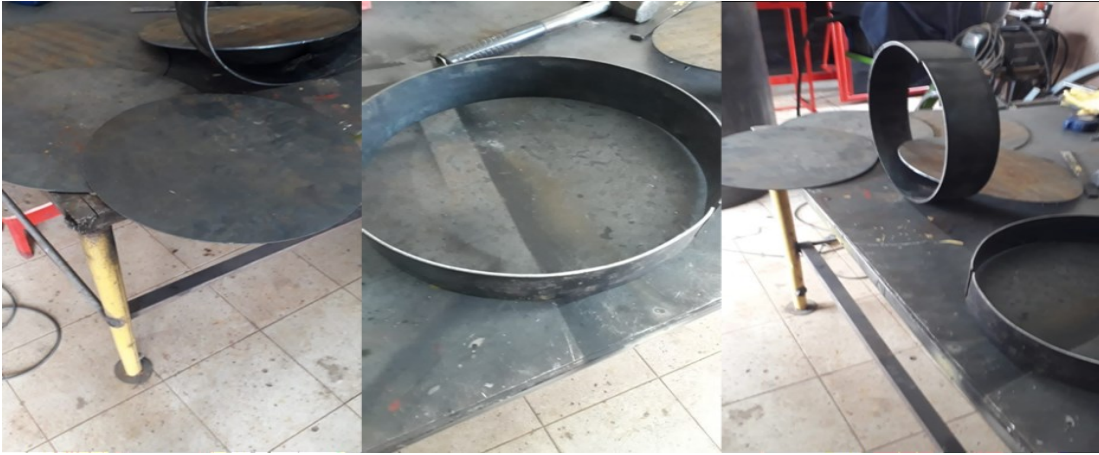
Figura 4-1. Corte de tapas simétricas y rolado de lámina para cubierta de tapas.
