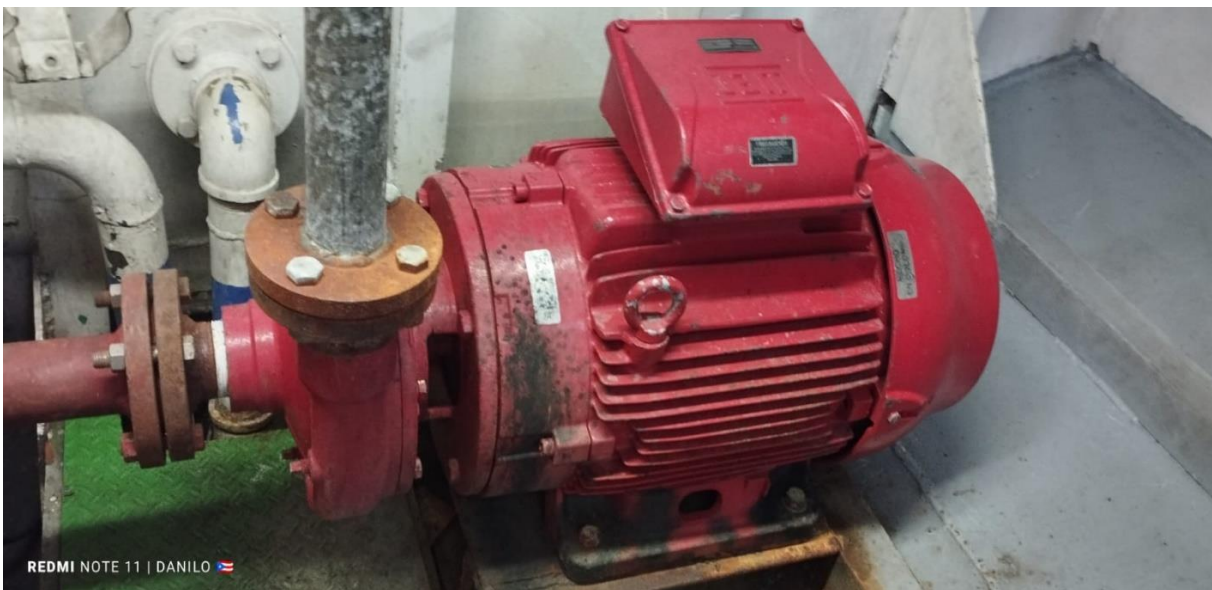
Bomba contra incendios
