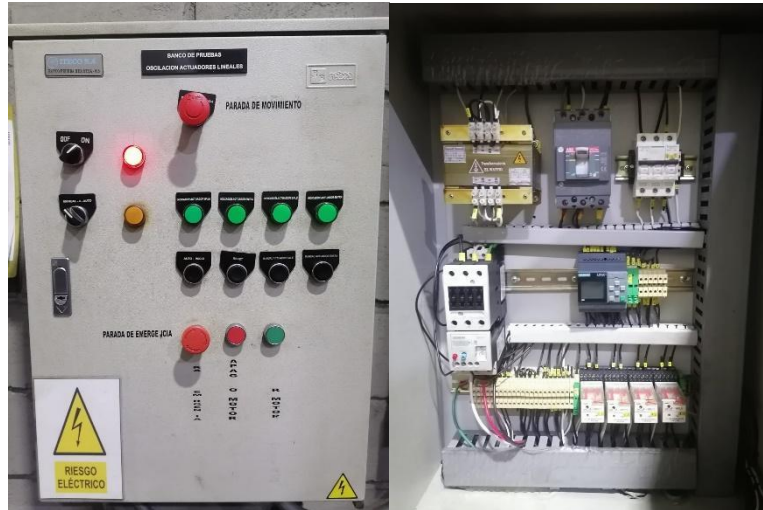
Figura 26. Controlador del banco de pruebas hidráulicas. Nota: de los autores.
