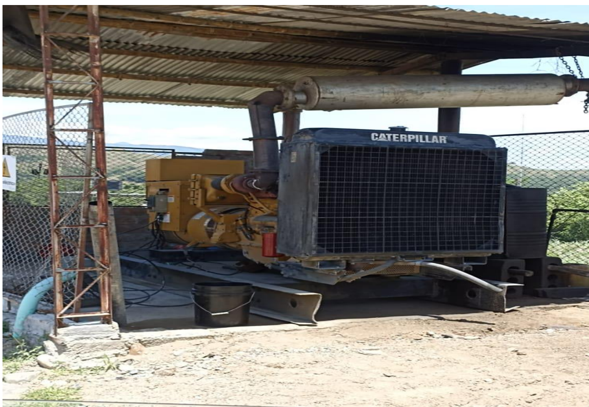
Figura 10. Planta Generadora Caterpillar
