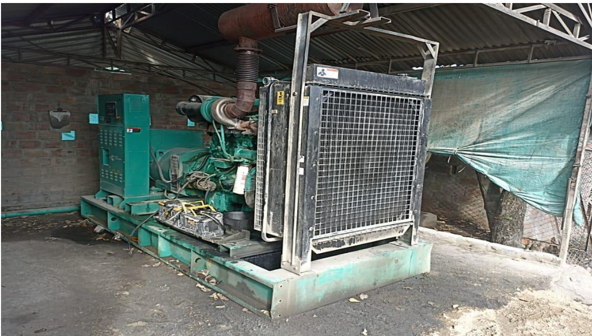
Figura 9. Planta Generadora Cummins
