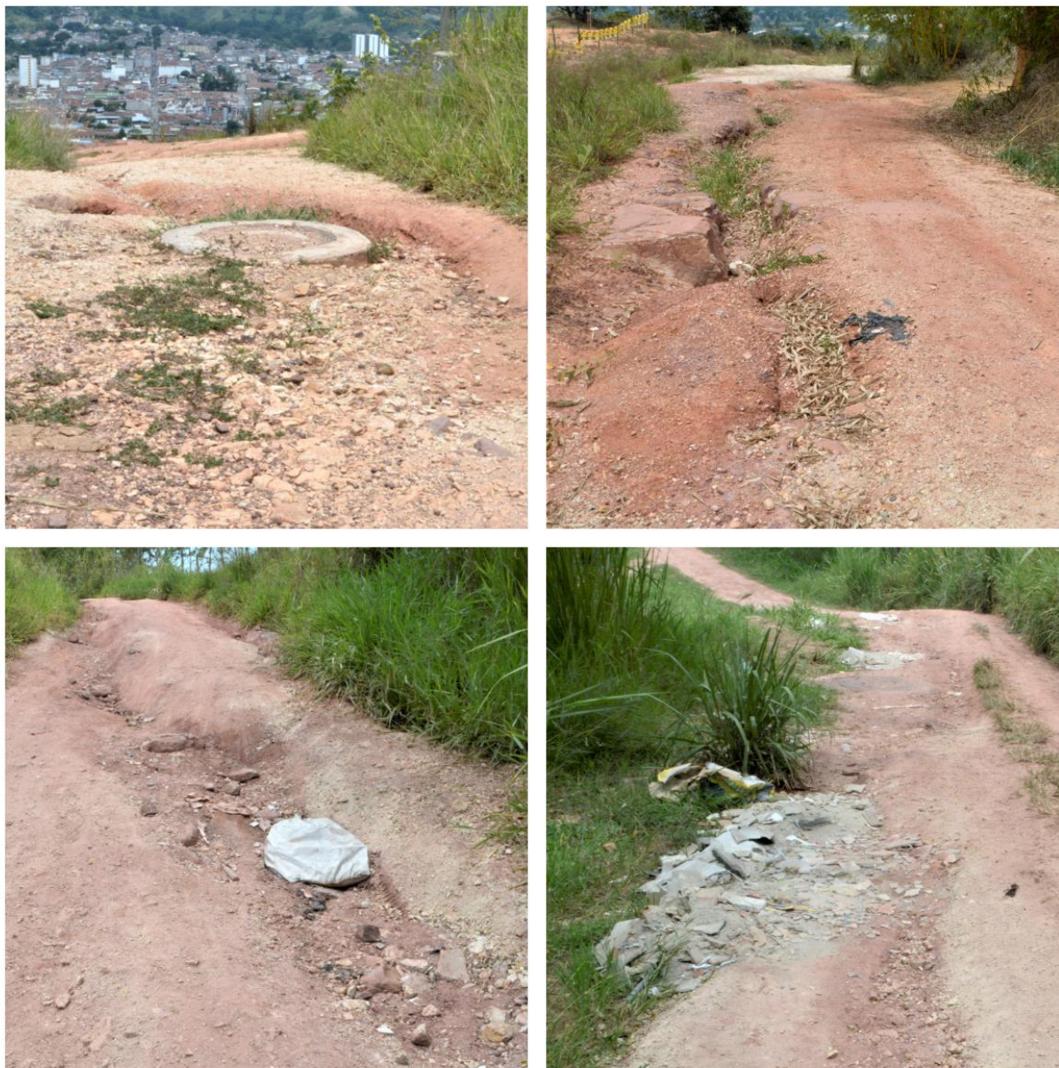
Figura 31. Fotografía Deterioro del acceso vehicular, Cerro de la Cantera en Piedecuesta - Santander. Extraído: Fuente propia.
