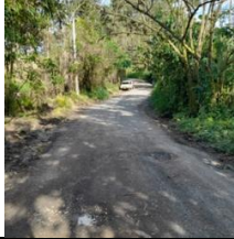
Estado actual, vía terciaria sin pavimentar UTP – Mundo nuevo - La Bella. (K0+000 – K0+350)
