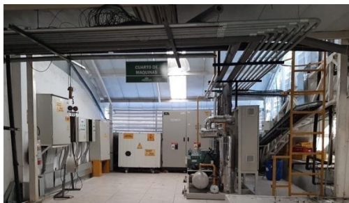
Figura 15. Área de máquinas FRIGOCIAM S.A.
