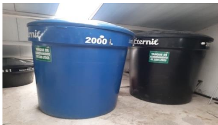
Figura 17 Tanques elevados FRIGOCIAM S.A.
