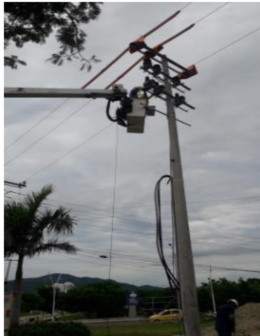
Gráfica 19 Toma de tiempos Instalación de Medida Indirecta
