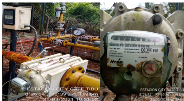
Figura 25. Medidor rotativo Intró Delta City Gate Tibú.
