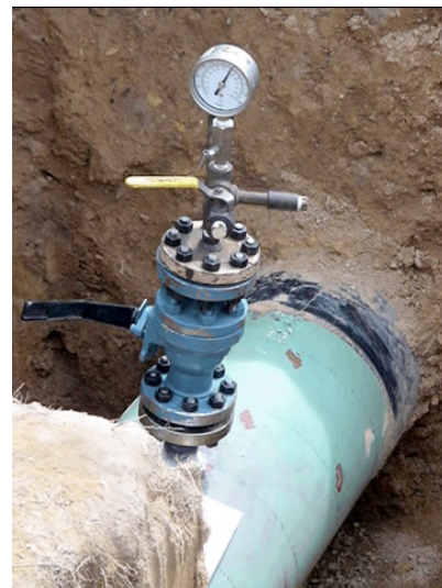
Figura 1. Punto de Conexión (HOT TAP), [6].
