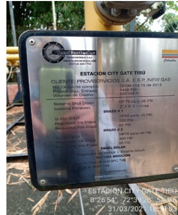
Figura 12. Estación City Gate Tibú
