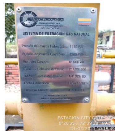
Figura 14. Sistema de filtración,
