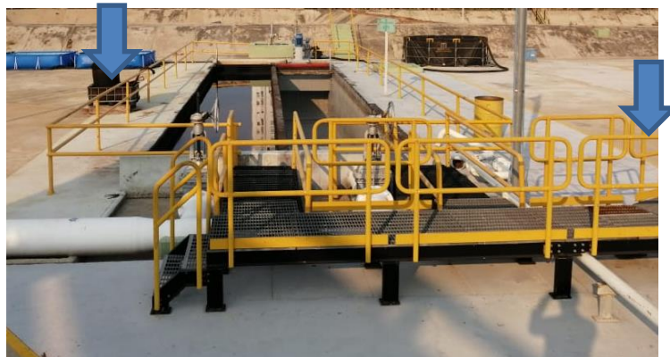
Figura 15:Tuberías de alimentación del separador API.
