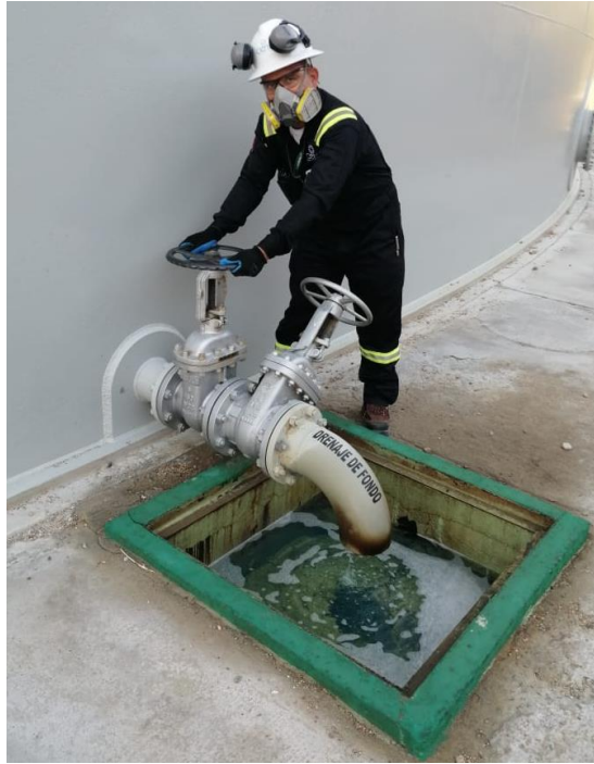
Figura 11 Drenaje de agua en un Tanque.
