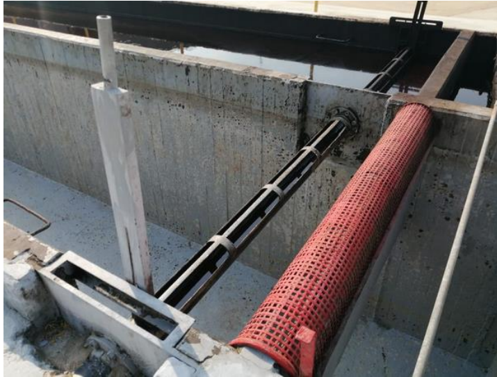
Figura 16: Flauta de Captación de producto superficial Separador API.
