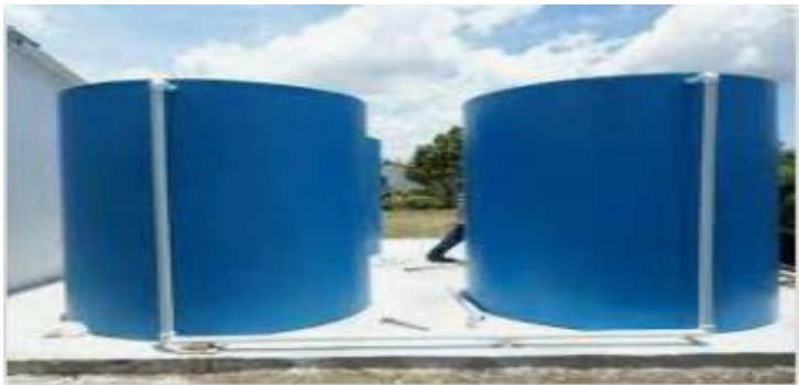
Figura 19: Almacenamiento de agua potable Nutrilácteos El Roble
