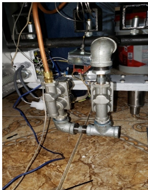
Figura 7-9: Ensamble electroválvulas para gas
