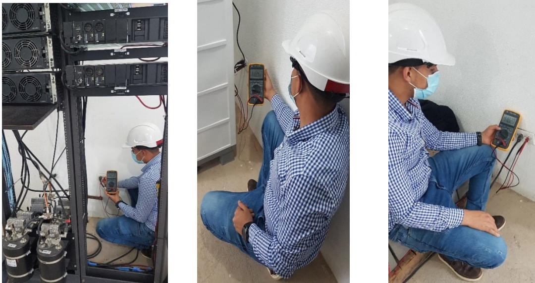
Figura 2-11: Pruebas de voltaje de corriente alterna. Fuente: Autores
