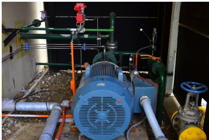
Figura 15. Conjunto motor-bomba de sistema de agua inyección CT2.
