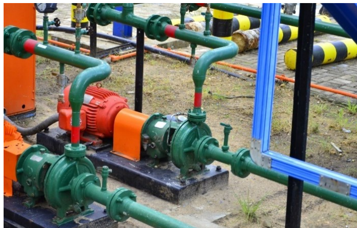
Figura 13. Bomba de suministro agua inyección CT2. Fuente: Autores
