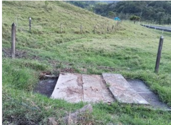
Figura 3-2. Tanque de almacenamiento de estiércol.
