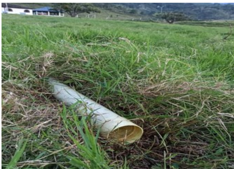
Figura 3-3. Salida de tanque de almacenamiento.
