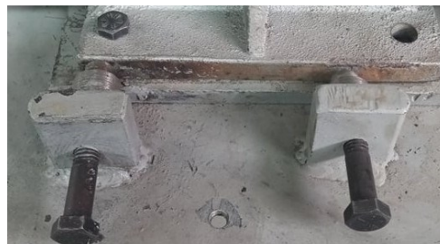
Figura 6-4: Tornillos de desplazamiento para generar desalineación del motor
