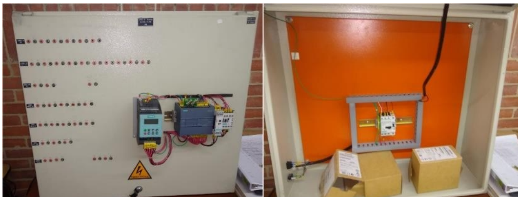
Figura 3-2: Estado actual del tablero eléctrico.
