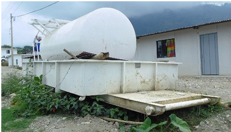
Figura 2. Tanque de agua potable. Fuente: Alcaldía Municipal de Miranda, Cauca.
