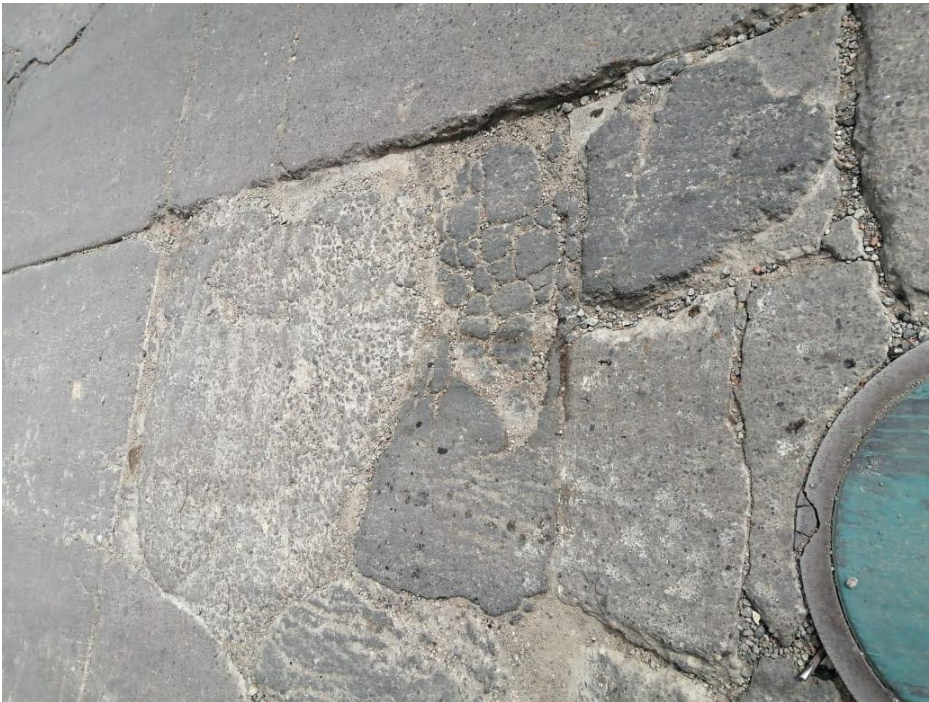
Figura 19 hundimiento - Vista superior
