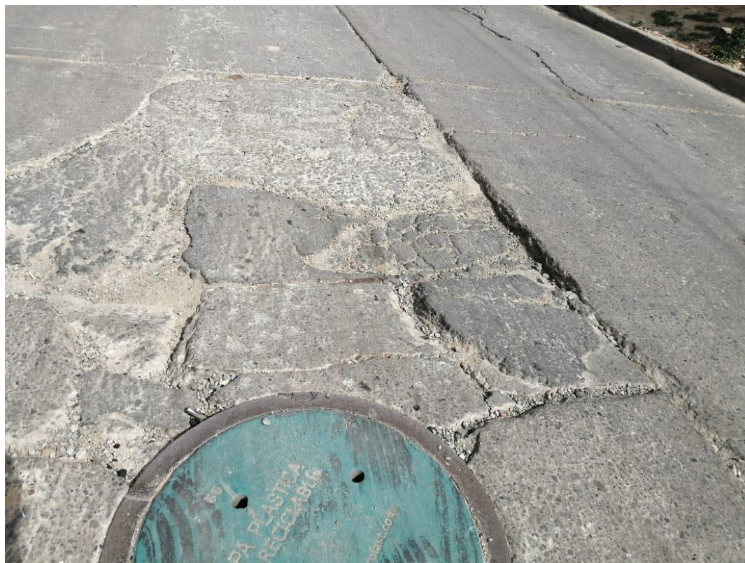
Figura 20 Hundimiento - Vista perfil izquierdo
