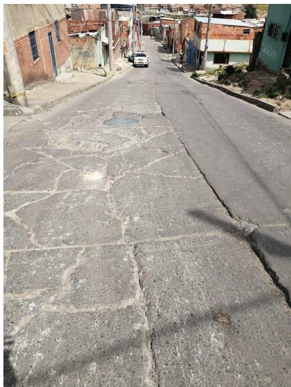
Figura 21 Hundimiento y fracturación múltiple
