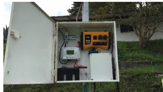
7.2.1. Tablero de control con todos los elementos conectados , aislados y en perfectas condiciones para su funcionamiento
