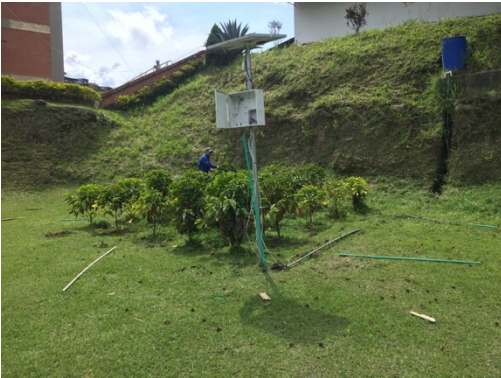
Fig. 5.2 Tablero de control instalado inicialmente
