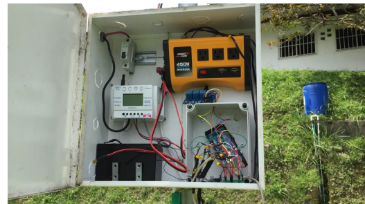
7.2. Elementos del tablero de control y cableado interior de sensores conectados a la placa Arduino
