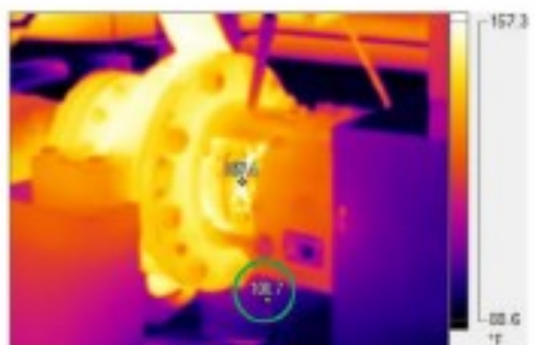
Figura 22. Termografía del sello mecánico y plan 53B.
