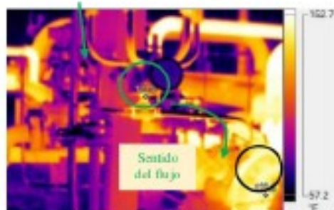
Figura 23. Termografía salida plan 53B - Entrada de sello mecánico.
