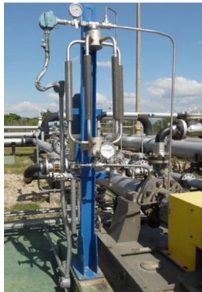
Figura 11. Instalación del plan 53B.
