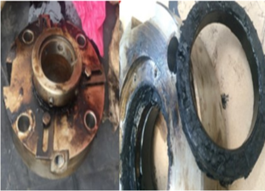
Figura 13. Inspección de sello mecánico. Izquierda, sello mecánico con evidencia de fuga. Derecha, componentes internos con material solidificado.
