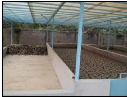
Ilustración 32: lecho de secado de lodos. Fuente: Grupo Deinco.
