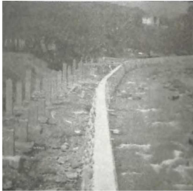
Ilustración 32: Muros de contención junto al río Cali en fase de ejecución; también se aprecian
